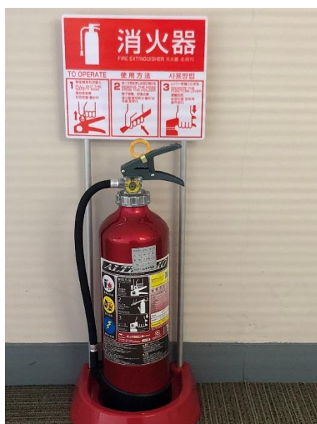
図 1.1 103号館設置写真
